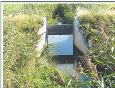
Eine Drosselblende hält Hochwässer für eine Zeit in dem dahinter liegenden Rückhalteraum zurück und mindert so die Hochwasserspitzen im Unterlauf. (Fotos: Diehl)
