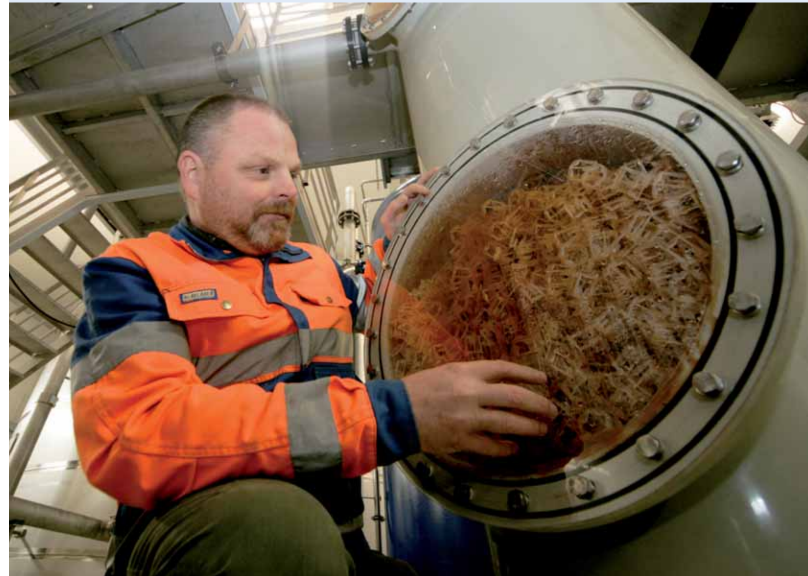
Im Hochbehälter in Rauischholzhausen läuft das Tiefenwasser durch einen Verrieselungsfiter - so wird ihm Kohlensäure entzogen.
